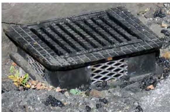
Bild 11. Exempel på anordning för att avleda vatten ner i brunn. Foto: Åke Sandin.
