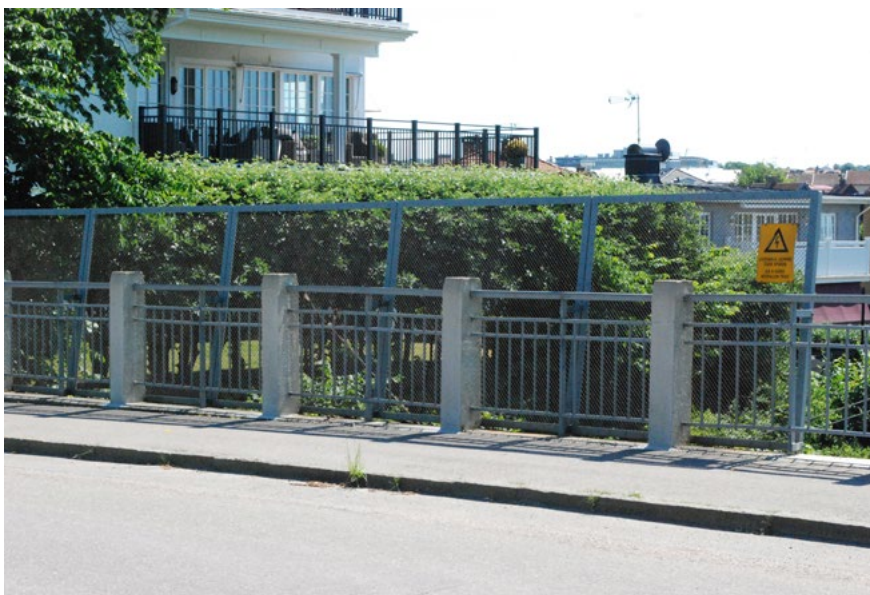
Bild 23. Stängsel vid broar över järnväg som ej är klättringsbara. Källa: Varbergs kommun.
