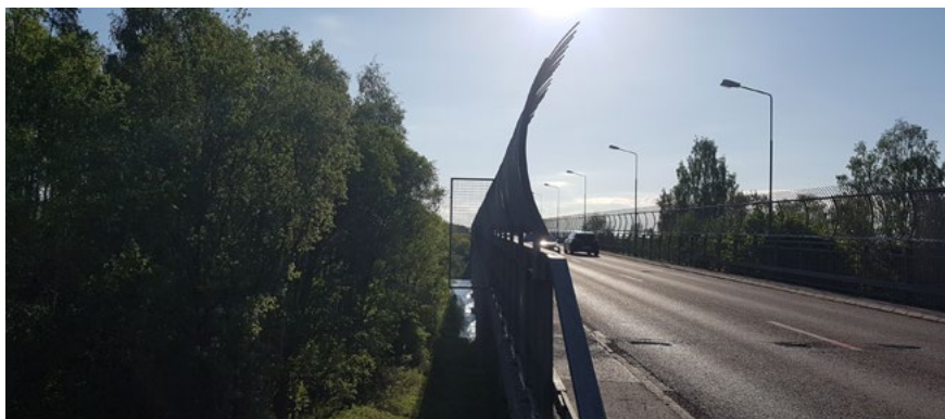
Bild 4. Ett exempel på konstruktion av broräcke med inåtböjd kurva i toppen för att försvåra överklättring. Alnöbron, Sundsvall. Källa: Sundsvalls kommun.
